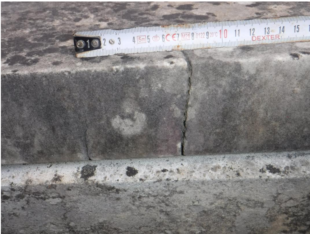
Fot. 13. Nagrobek Matyldy Jaroszyńskiej na cmentarzu Champaux w Montmorency, Francja. Zbliżenie na jedno z pęknięć w płycie nakrywającej. Stan na maj 2025r.
