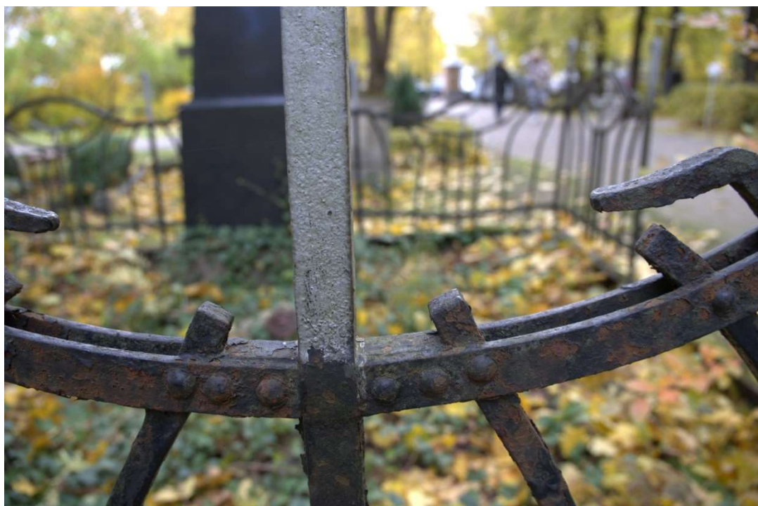
Fot. nr 22. Ogrodzenie nagrobka Aleksandra Rudzińskiego oraz Maryi Wyrzykowskiej z cmentarza św. Michała w Rydze, Łotwa, front. Widoczny fragment ze złuszczającą się farbą oraz ogniska korozji metalu, październik 2023 r. Autor fot. Marta Butkiewicz.
