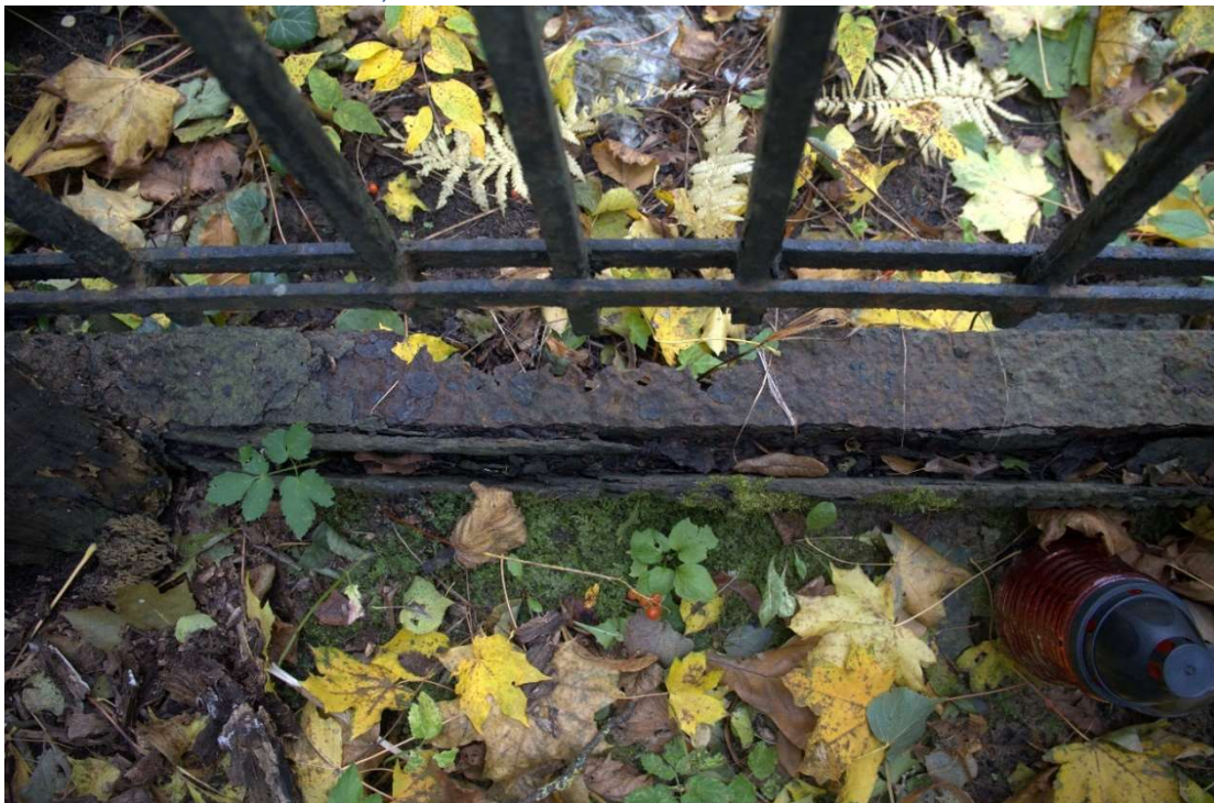
Fot. nr 24. Ogrodzenie nagrobka Aleksandra Rudzińskiego oraz Maryi Wyrzykowskiej z cmentarza św. Michała w Rydze, Łotwa, prawy bok. Widoczny fragment zdestruowanej ławy, październik 2023 r. Autor fot. Marta Butkiewicz.
