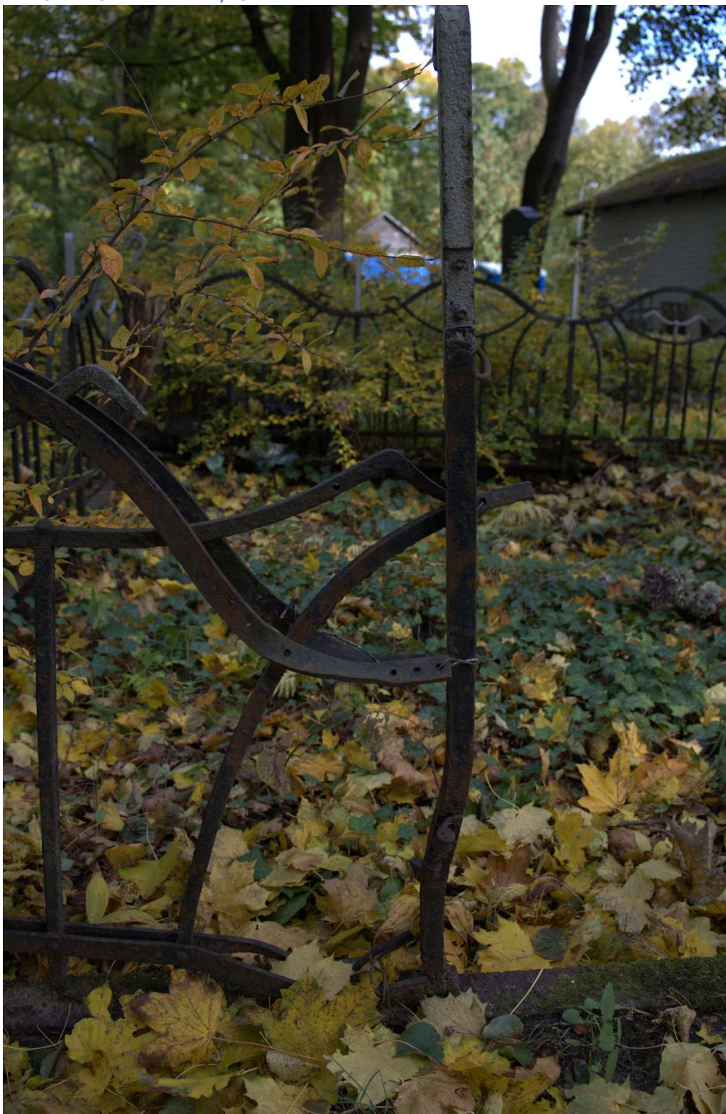
Fot. nr 20. Ogrodzenie nagrobka Aleksandra Rudzińskiego oraz Maryi Wyrzykowskiej z cmentarza św. Michała w Rydze, Łotwa, lewy bok. Widoczne odkształcenia, październik 2023 r. Autor fot. Marta Butkiewicz.
