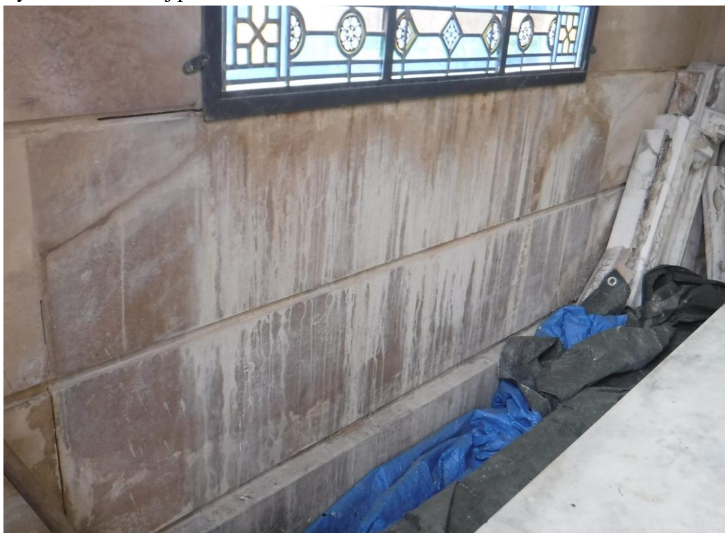
Fot. 10. Kaplica grobowa Mikołaja Jaroszyńskiego na cmentarzu Champaux w Montmorency, Francja, po 1890r. Zbliżenie na ścianę pod witrażem we wnętrzu kaplicy. Widoczne liczne zacieki. Stan na luty 2024 roku.
