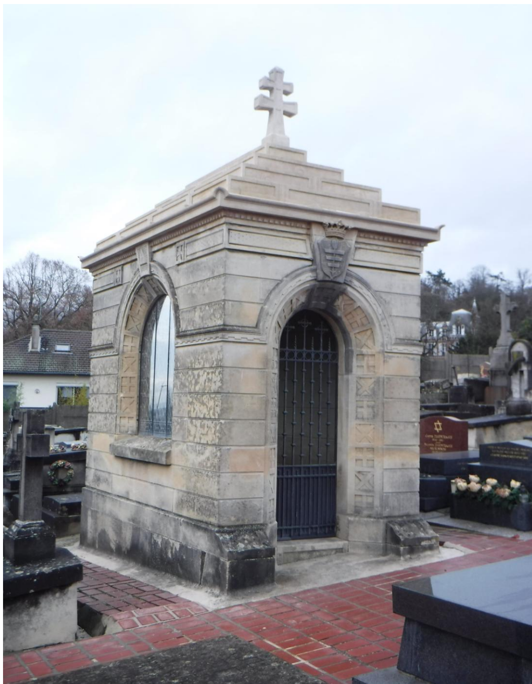
Fot. 1. Kaplica grobowa Mikołaja Jaroszyńskiego na cmentarzu Champaux w Montmorency, Francja, po 1890r. Widok trzy czwarte od strony południowo-wschodniej. Stan po II etapie prac w 2020 roku.
