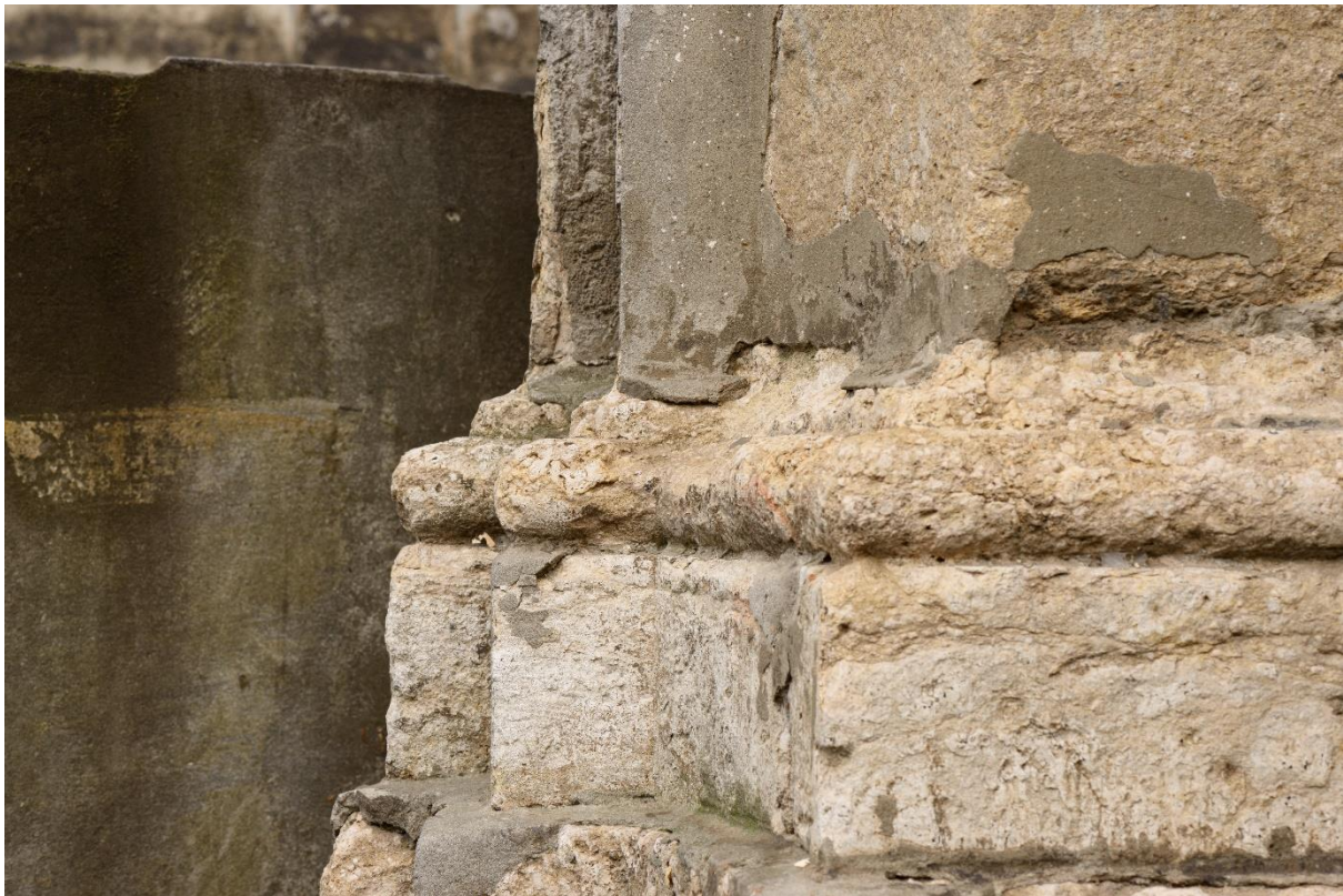
Fot. 84. Ubytki warstwy powierzchniowej gzymsów powstałe na skutek osłabienia lepiszcza i spoistości wapienia oraz działań mechanicznych typu otarcia przechodniów lub turystów.
