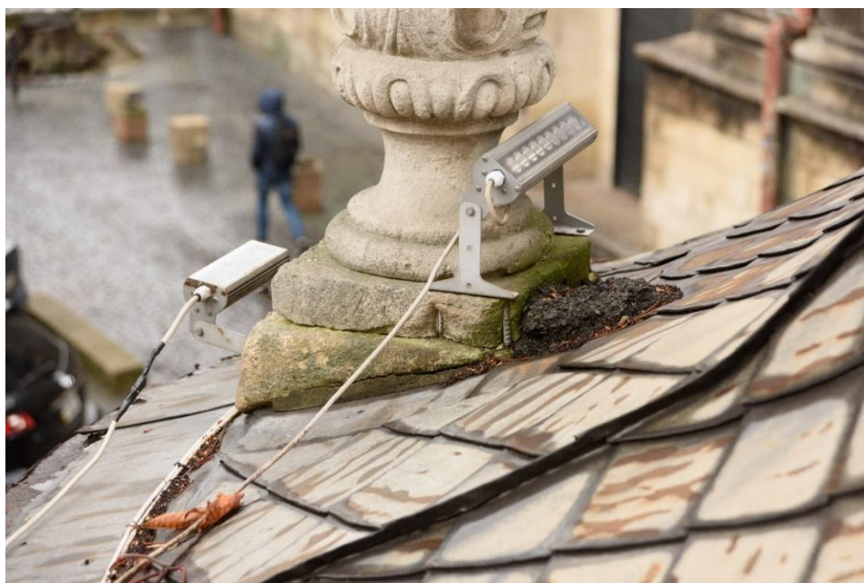
Fot. 96. Niedobre pod względem estetycznym lampy oraz widoczne zniszczenia cokołu pod wazą, błędnie wykonane ofasowania stalowe, a raczej ich brak.
