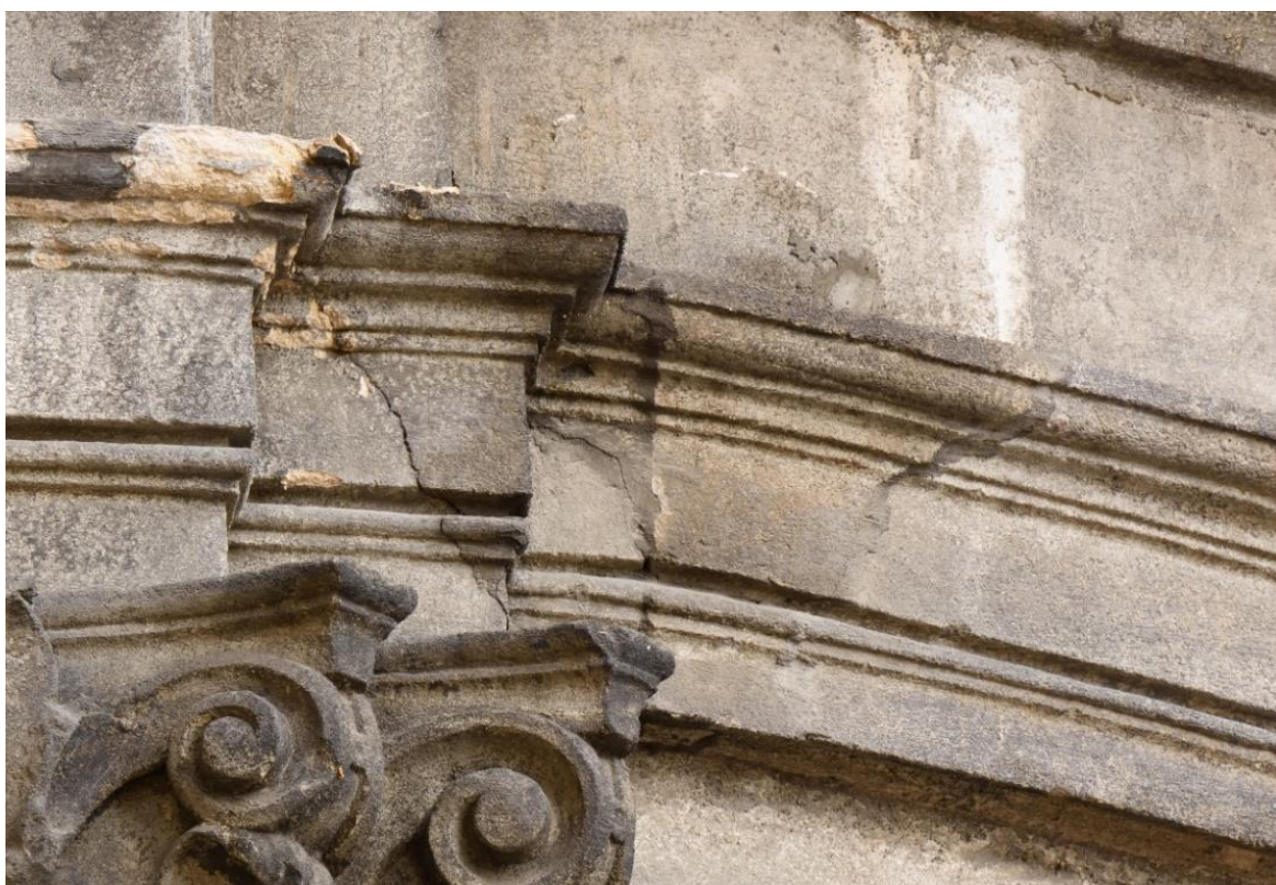
Fot. 78. Spękane fragmenty gzymsu oraz uzupełnienia spękań wykonane podczas prac renowacyjnych lub naprawczych niewłaściwie dobraną zaprawą.
