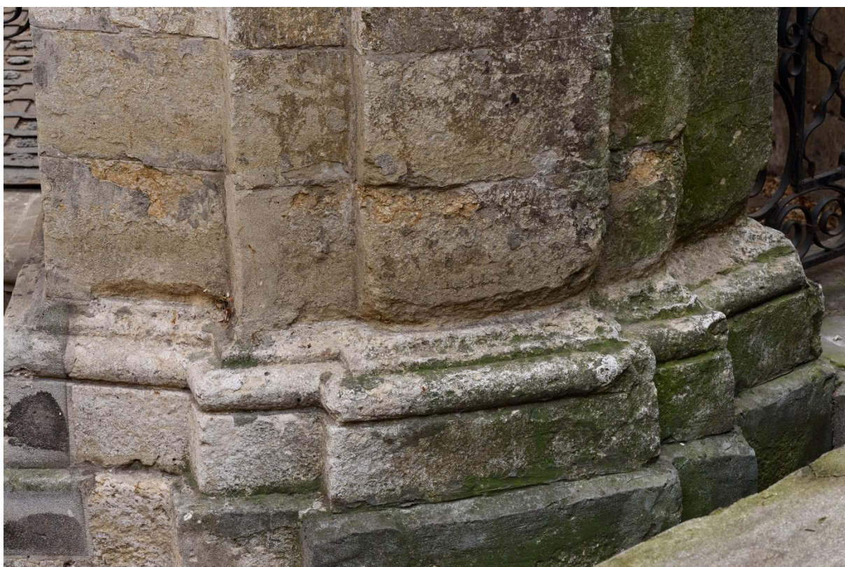
Fot. 72. Nawarstwienia mikrobiologiczne, zazielenienia pokrywające cokół filara od strony północnej.
