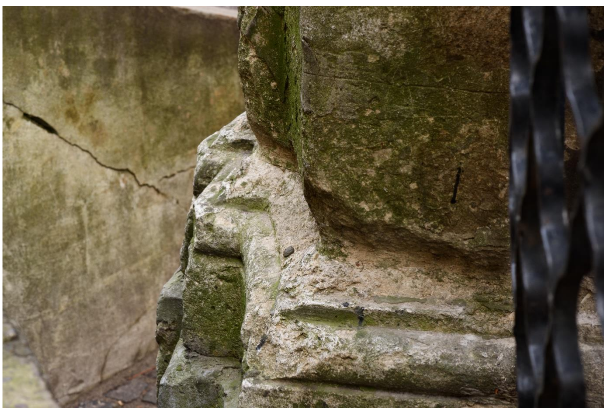
Fot. 80. Dezintegracja granularna i rozpadanie się materiału skalnego przez działanie wilgoci z podsiąkania kapilarnego i wód opadowych oraz soli rozpuszczalnych w wodzie.
