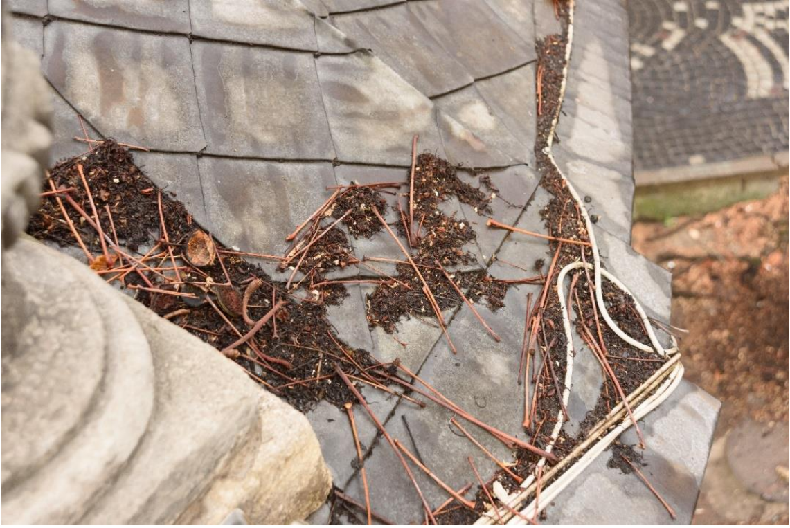
Fot. 97. Zalegające na dachu resztki roślinne.
