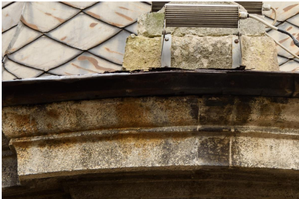
Fot. 94. Przebarwiony od działania rdzy gzyms górny, widoczne intensywne zaplamienia żelaziste.
