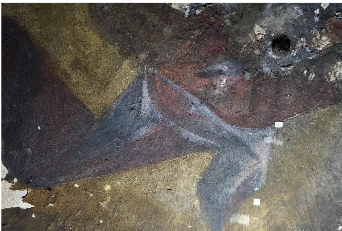
Fot. 50. Chrystus w centrum kompozycji u szczytu kopuły. Malowidło z widocznym odcisniętym rysunkiem przygotowawczym.
