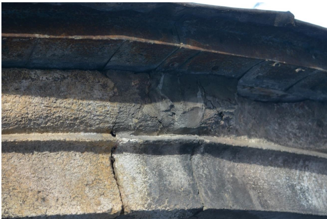
Fot. 35. Uzupelnienie cementem ubytku w gzymsie górnym, widoczna skorodowana blacha budująca obręcz dachu, z pozostałościami śladów po pierwotnym ocynkowaniu.
