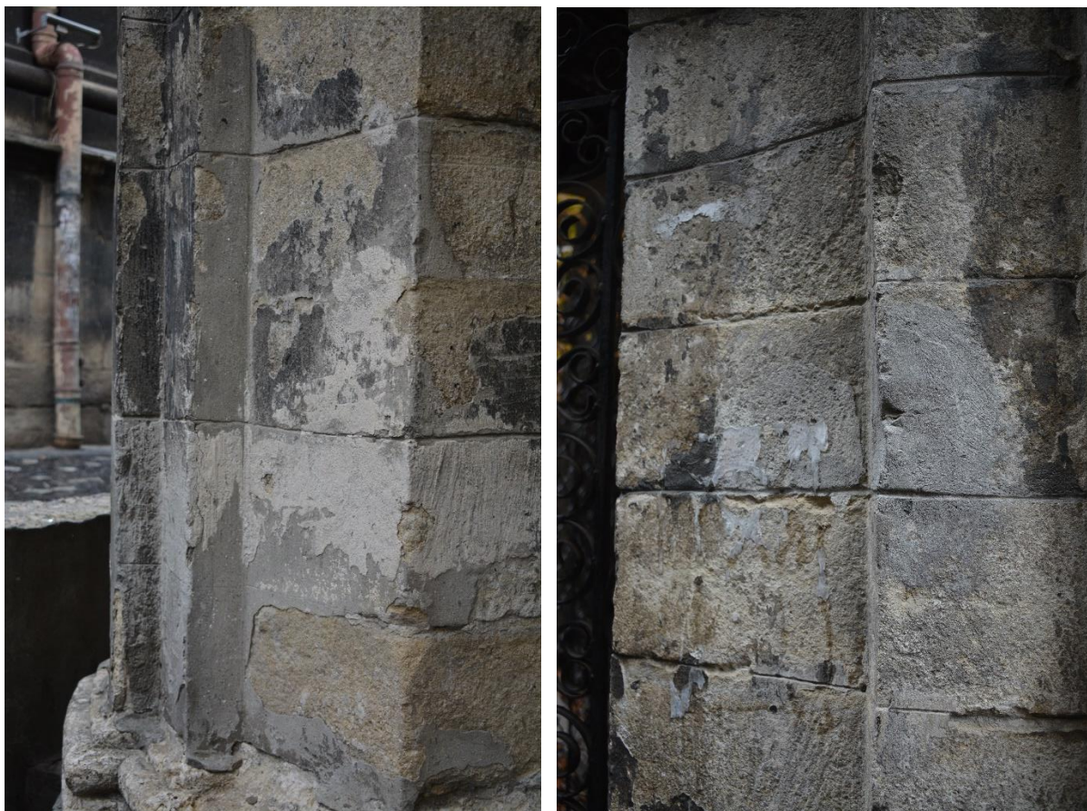
Fot. 87, 88. Widoczne różnego rodzaju nieestetyczne zaprawy naprawcze – ciemnoszare, jasnoszare, białe, cement, zacierka w kolorze beżowym, wpływające na zniszczenia kamienia.
