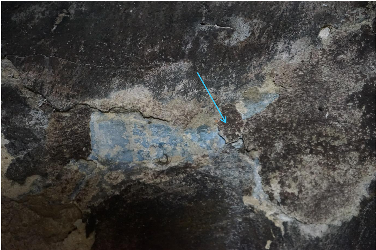
Fot. 107. Późniejsza naprawa ubytków tynku, leżąca na niebieskiej warstwie malarskiej.
