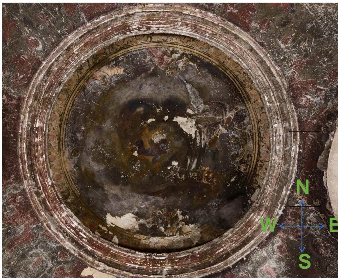
Fot. 98. Malowidło w kopule studni przy kościele Bernardynów. Widok ogólny. Malowidło mocno pociemniałe, z dużą ilością ubytków tynku i warstwy malarskiej.
