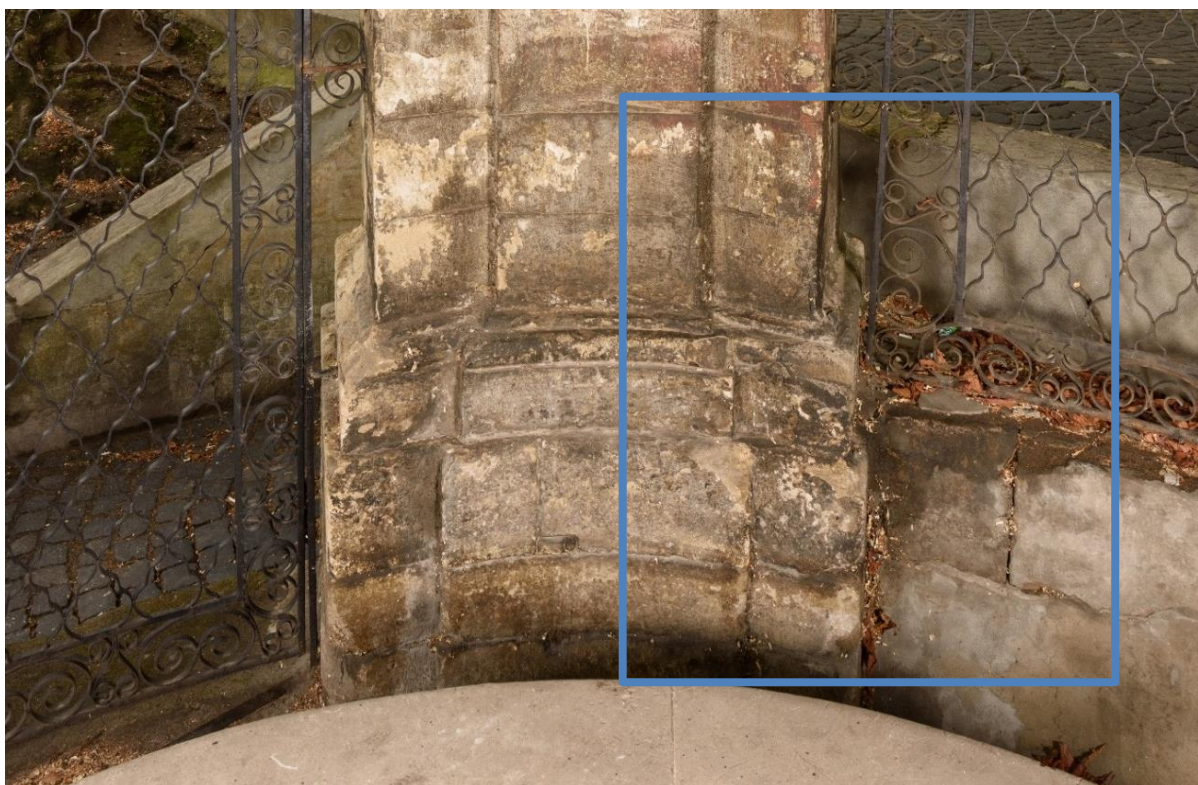
Fot. 66. Zawilgocenie betonowego muru między studnią, a kościołem oraz schodka betonowego łączącego cokół filara z murem. Widoczne spękania w betonie, oraz nagromadzenie liści utrzymujących wilgoć.
