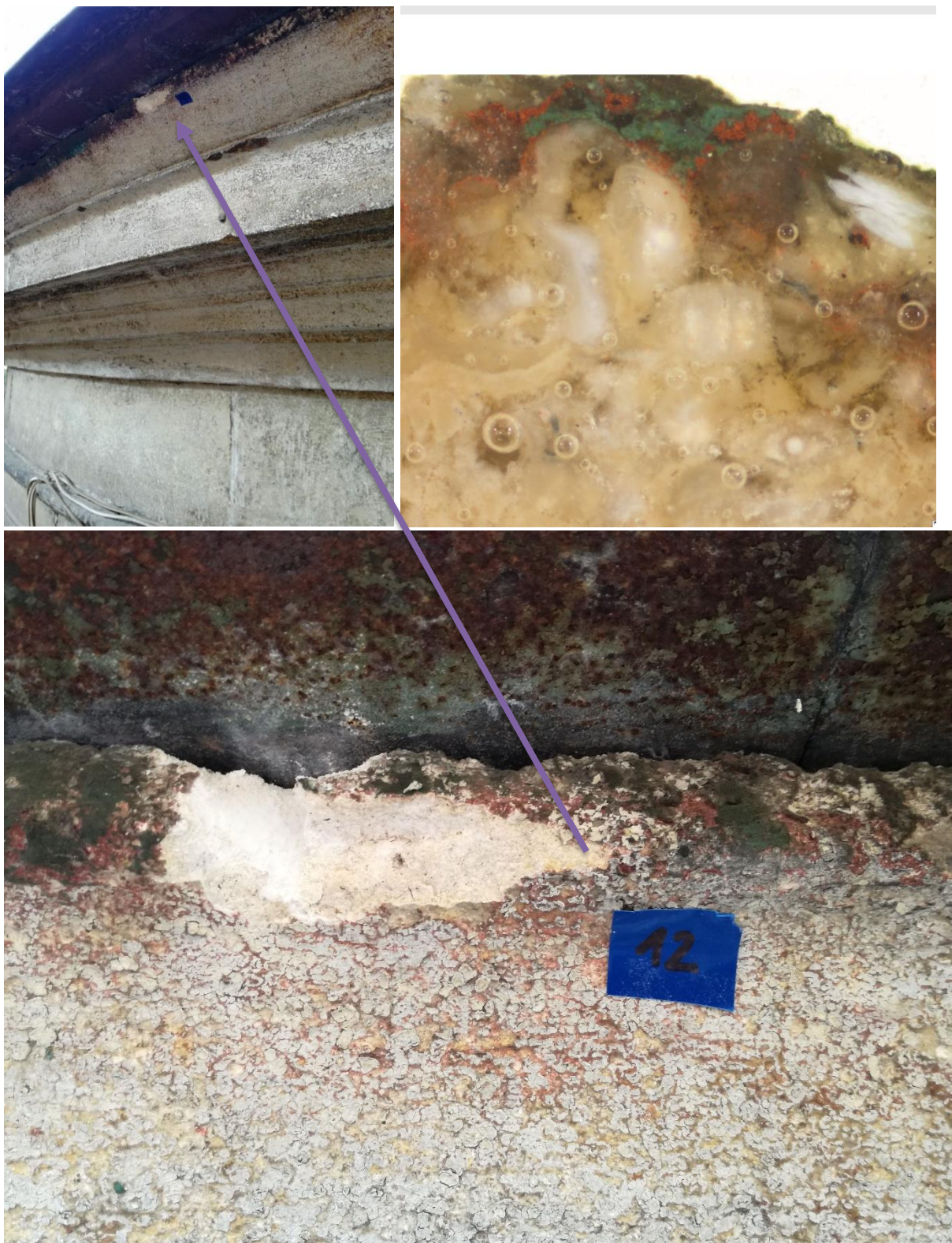
Fot. 25, 26 i 27. Gzyms górny pokryty warstwami barwnymi, widoczna czerwona warstwa barwna oraz wtórna warstwa z zielenią szwajcurską (1814 – 1900 r.). Miejsce pobrania próby na gzymsie wieńczącym, od strony pld.
