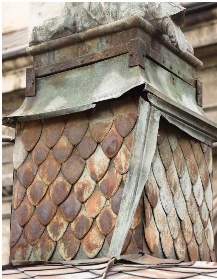
Fot. 58. Podstawa figury z dachówkami w kształcie rybich łusek. Widoczna silna korozja dachówek.
