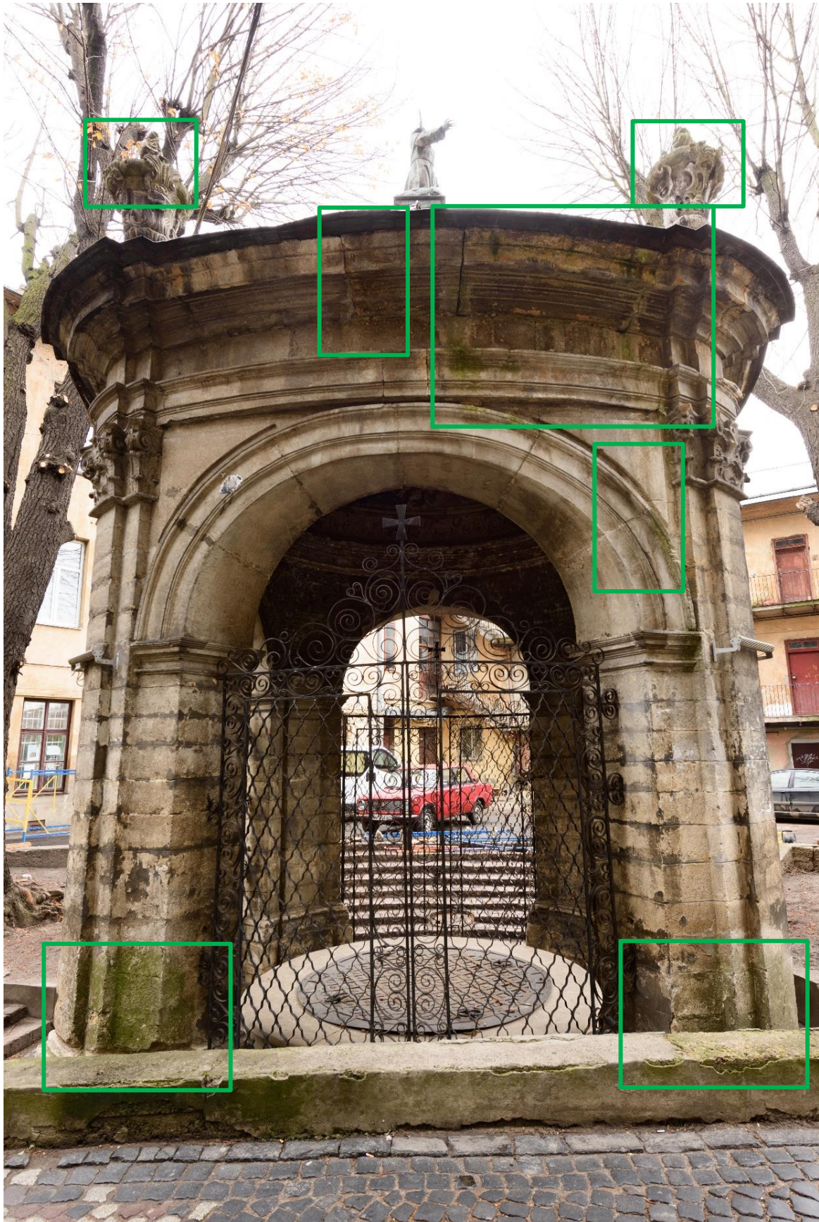
Fot. 70. Studnia od strony północnej, widoczne miejsca ataku mikrobiologicznego.
