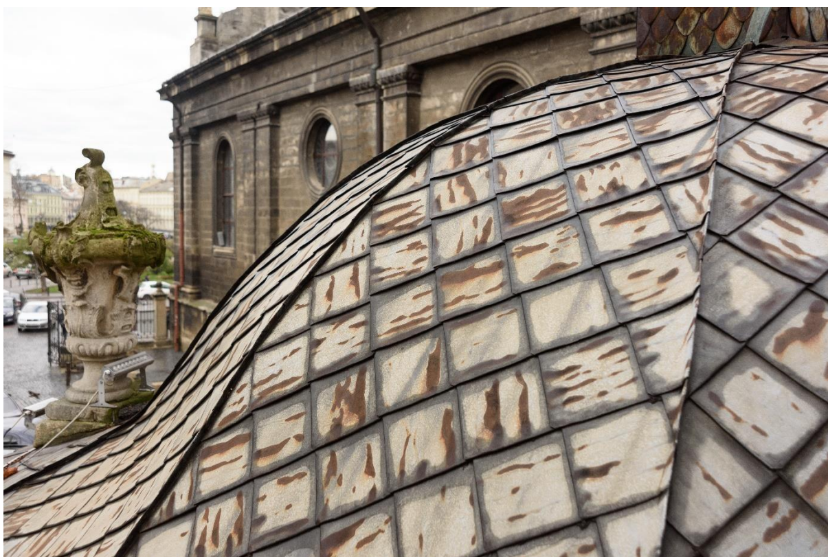
Fot. 114. Widoczne miejsca w których skorodowała dachówka.
