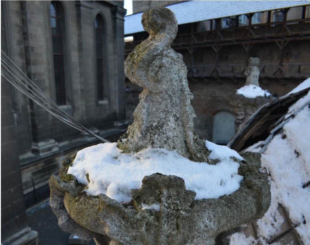
Fot. 85. Wyplukanie warstwy powierzchniowej kamienia na powierzchni pokrywy wazy. W efekcie powierzchnia stała się chropowata i porowata, a forma rzeźbiarska uległa wyobleniu.
