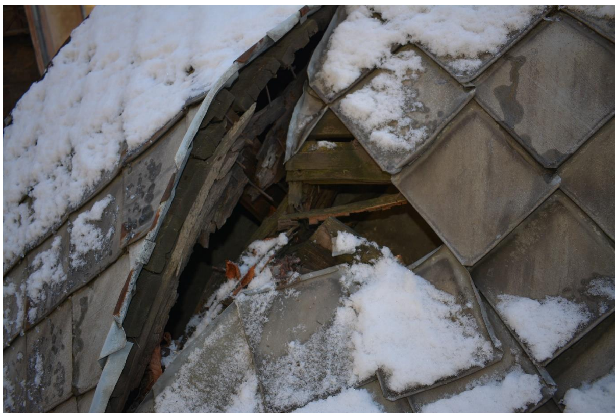
Fot. 113. Uszkodzone poszycie dachowe.
