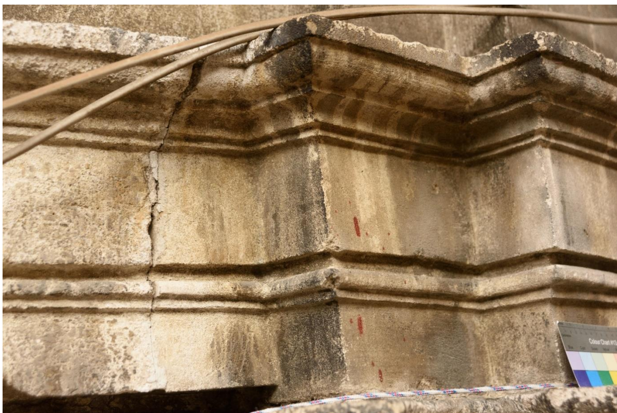
Fot. 76. Nierównomierny rozkład nawarstwień czarnych i szarych pochodzenia atmosferycznego, mocno scalonych z podłożem. Widoczne ślady po zaciekach od wody.
