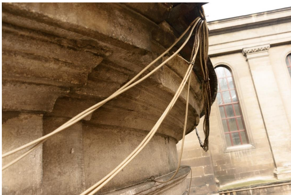
Fot. 95. Wisząca bezładnie instalacja elektryczna.
