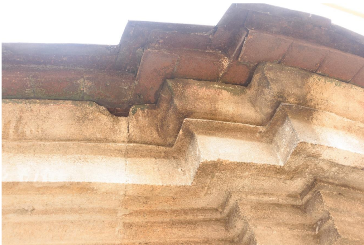
Fot. 117. Widoczna korozja blachy pokrywającej obręcz dachu.
