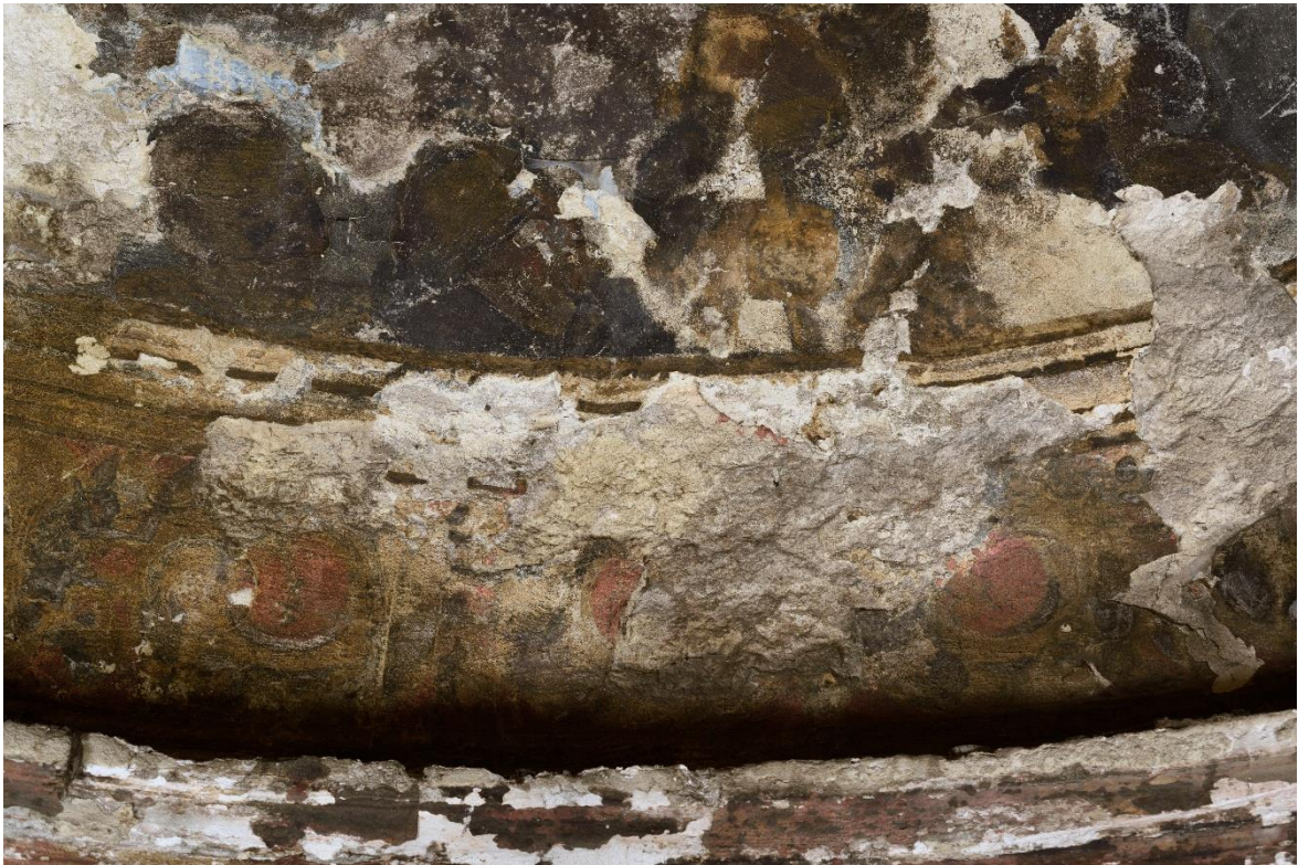
Fot. 106. Strona północna ponad gzymsem, jedno z bardziej zniszczonych miejsc na sklepieniu.
