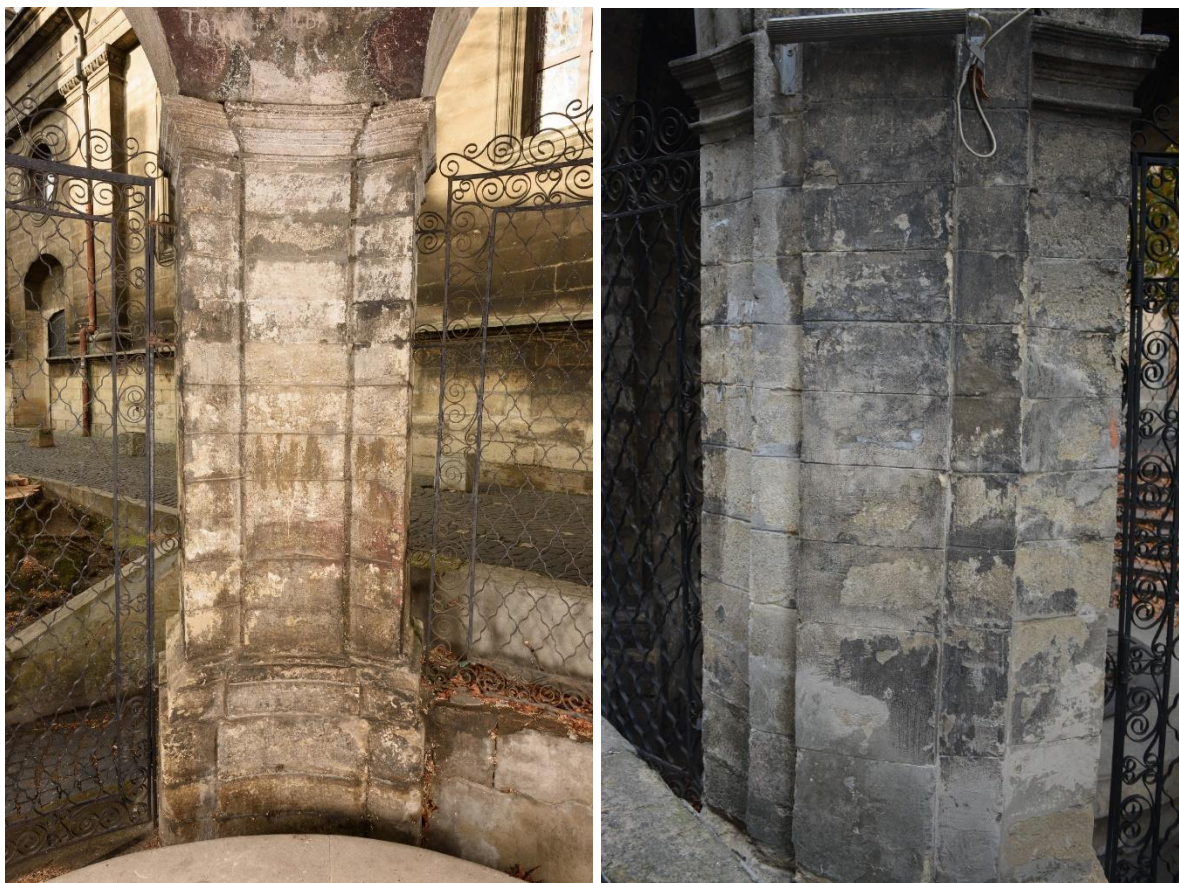
Fot. 90, 91. Widoczny zakres powierzchni pokrytej zaprawami wtórnymi i naprawczymi.
