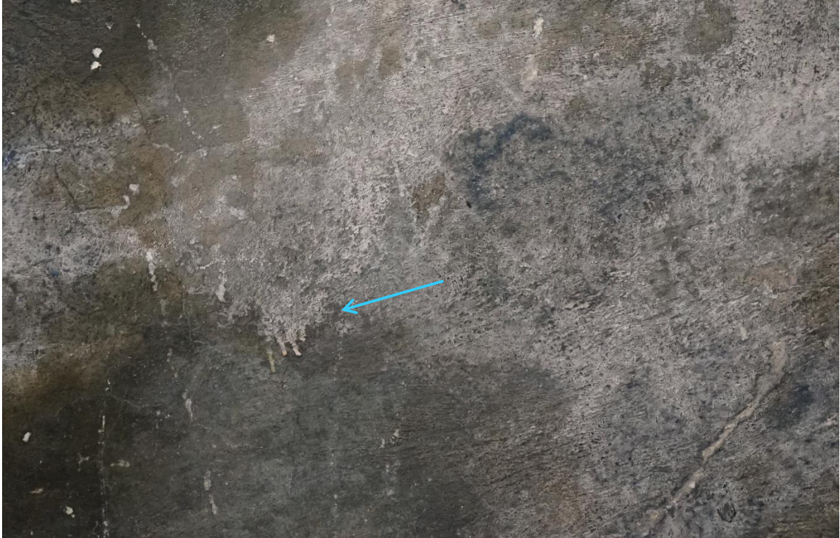
Fot. 100. Zaciek powstały w wyniku migracji wody z dachu obiektu.
