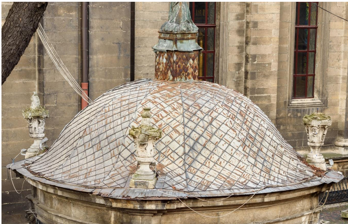
Fot. 55. Widok ogólny na dach i jego stan zachowania. Widoczna korozja krawędzi dachu oraz korozja dachówek.
