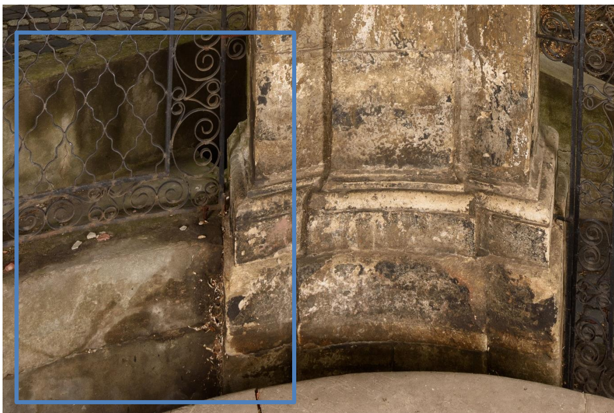
Fot. 65. Zawilgocenie betonowego muru między studnią, a kościołem oraz schodka betonowego łączącego cokół filara z murem. Widoczne zniszczenia betonu – spękania, ubytki.
