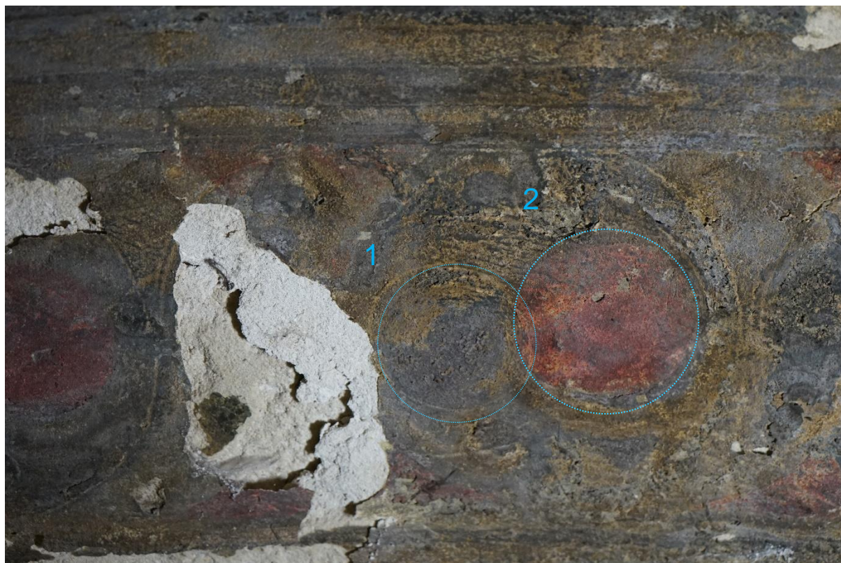
Fot. 109. Balustrada, strona północna. Widoczny odcisnięty w tynku rysunek starej kompozycji (1) i powtórzony czerwony element nowej kompozycji, namalowany obok rytu po prawej stronie (2).
