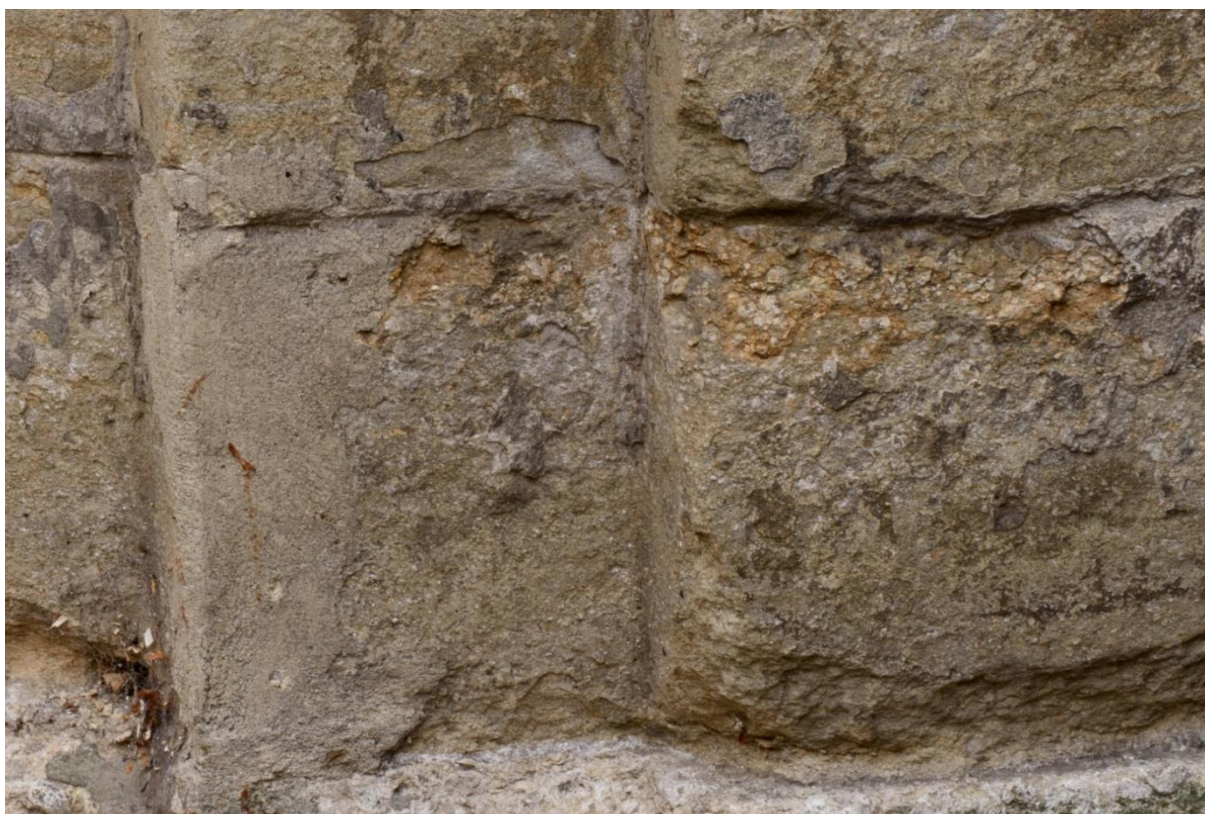
Fot. 79. Odspojony fragment zaprawy wtórnej wraz z uszkodzoną powierzchnią kamienia. Widoczne pudrowanie kamienia oraz wysoki poziom zażelazienia skały.
