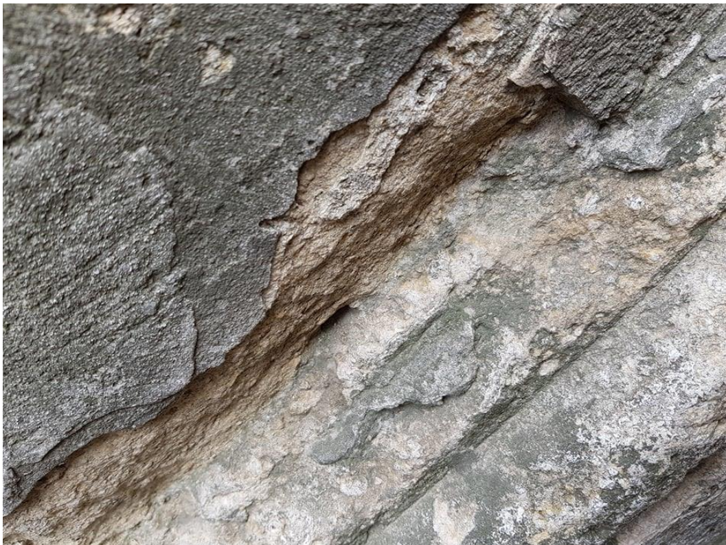
Fot. 86. Złuszczenie i osłabienie lepiszcza materiału skalnego. Widoczna szlichta cementowa, która doprowadziła do uszczelnienia kamienia.
