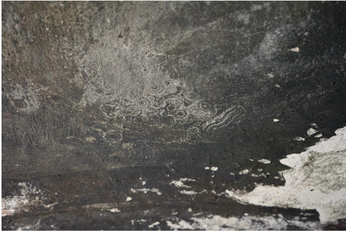
Fot. 103. Ślady działalności wody, utrwalonej w formie zacieków wypłukany kalcyt.
