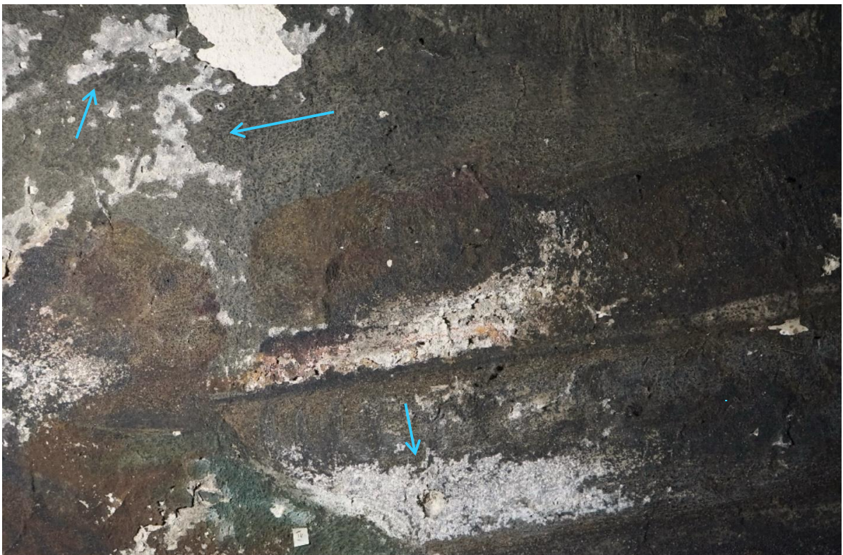
Fot. 101. Malowidło w kopule studni przy kościele Bernardynów. Fragment ukazujący głowę anioła, znajdującego się po lewej stronie. Strzałki wskazują miejsca pojawienia się wysoleń.
