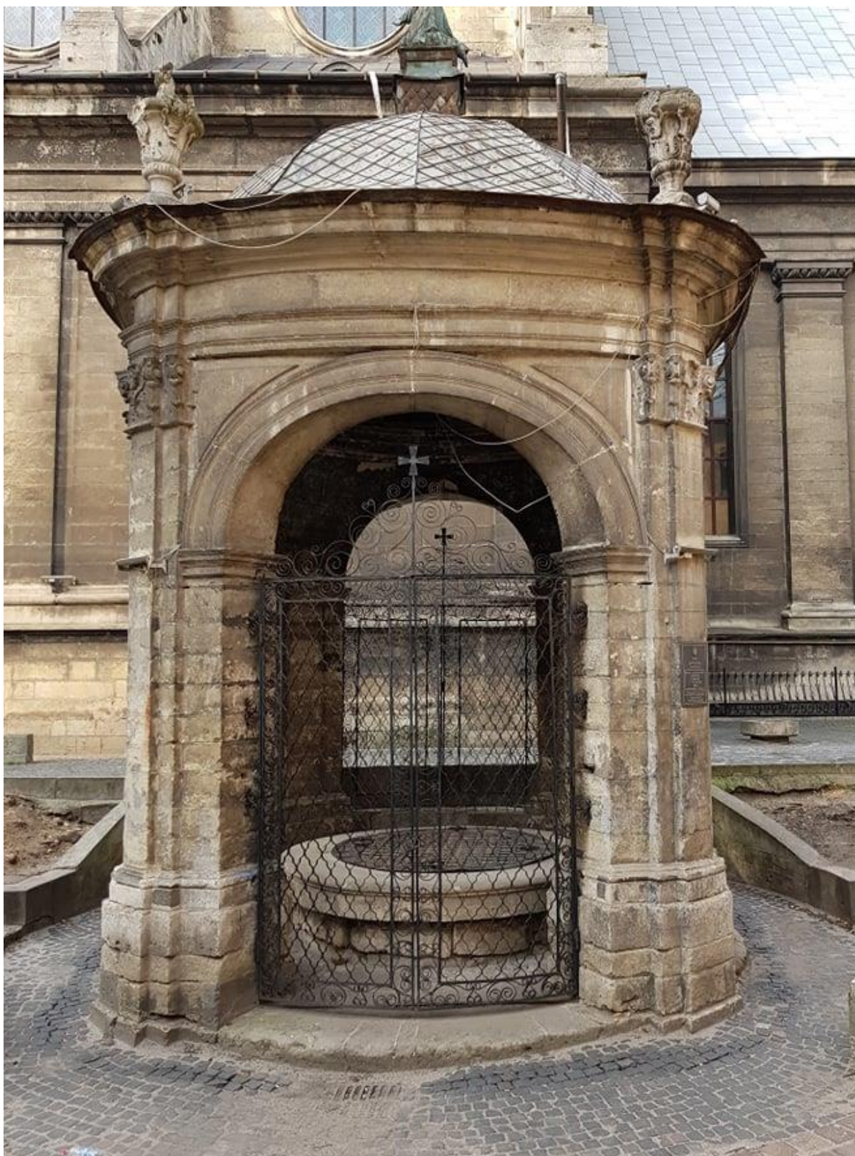
Fot. 67. Stan zachowania obiektu w marcu 2020 roku, po okresie odwilży, ale również po dwóch tygodniach bez opadów deszczu. Widoczne uszkodzenie nawierzchni w postaci kostki brukowej.
