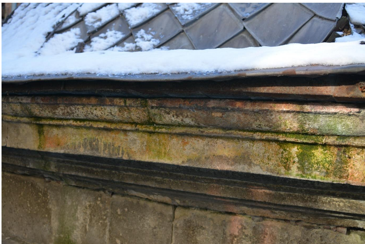
Fot. 71. Nawarstwienia mikrobiologiczne pokrywające gzyms od strony północnej. Widoczne zacieki spowodowane uszkodzonym pokryciem dachowym.
