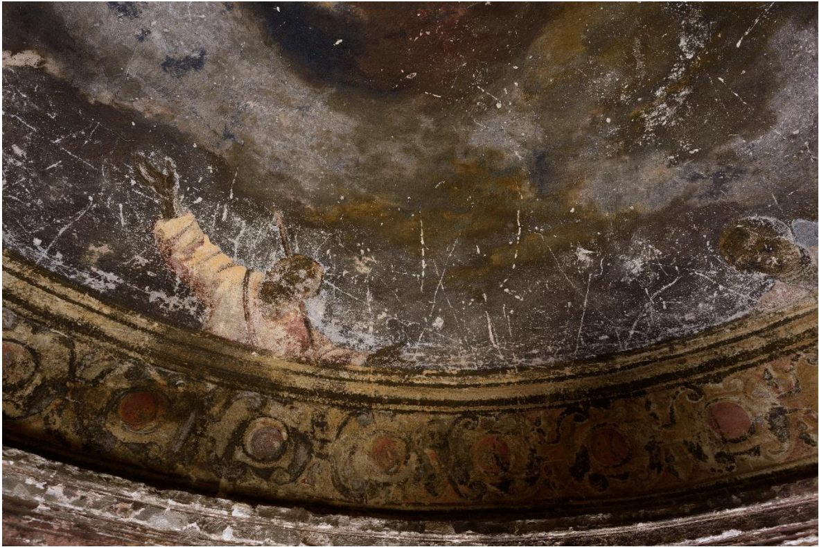
Fot. 105. Uszkodzenia mechaniczne polichromii, widoczne powyżej iluzjonistycznie rozmalowanie balustrady.
