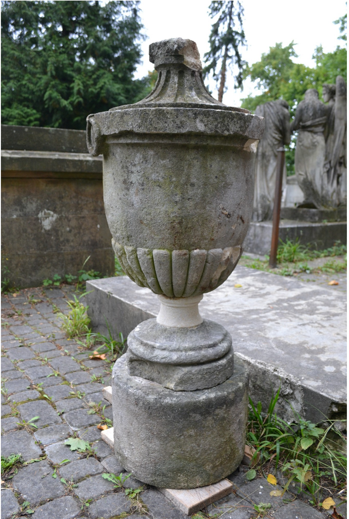
Fot. 15 Ze względu na brak kontynuacji w przełomach spowodowanym silnym uderzeniem podczas upadku, wykonano flek konstrukcyjny przywracający pierwotny kształt wazy
