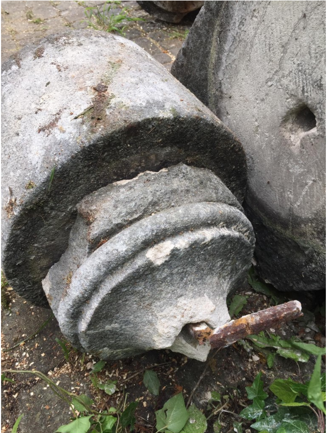
Fot. 3 stan przed przystąpieniem do prac interwencyjnych wykonanych w 2020 r
