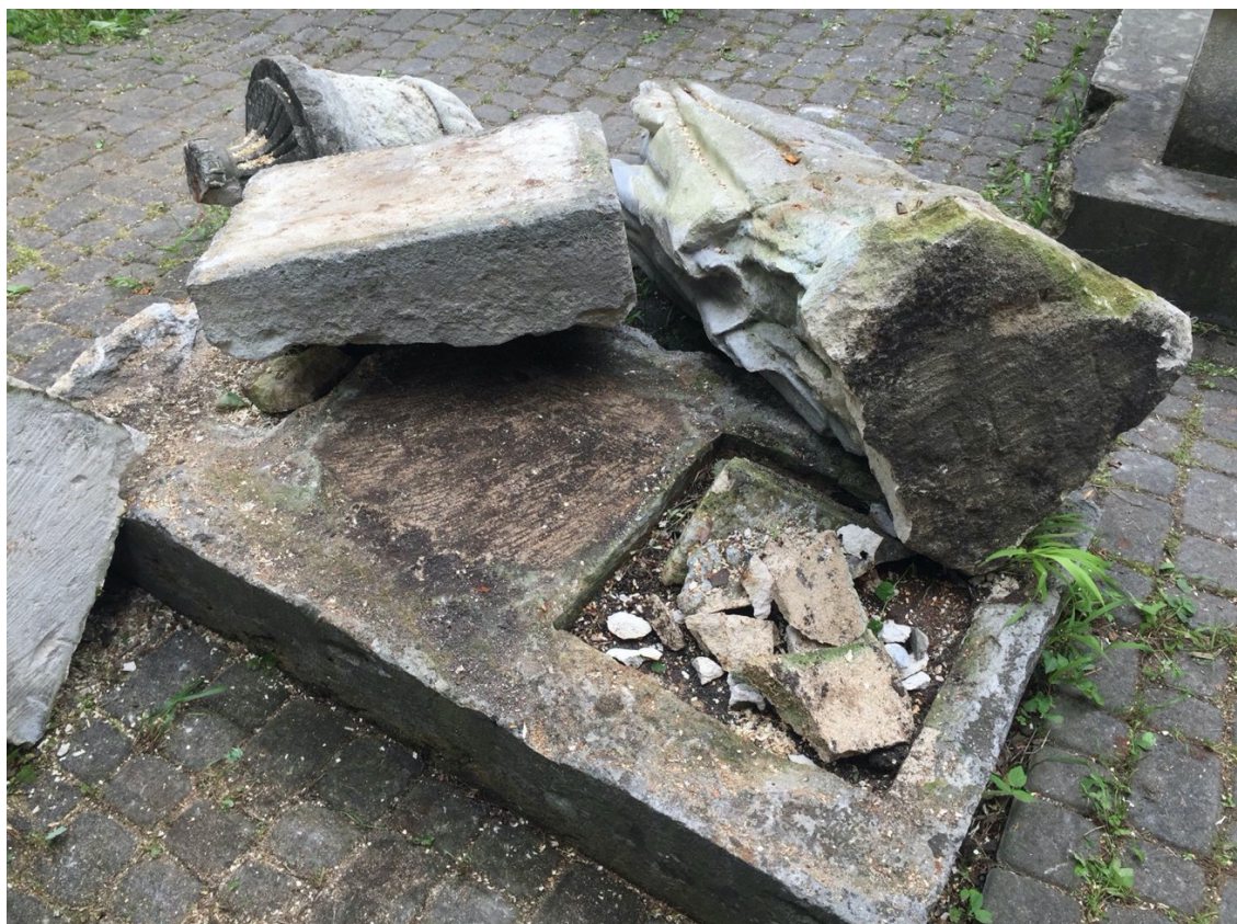
Fot. 6 stan przed przystąpieniem do prac interwencyjnych wykonanych w 2020 r
