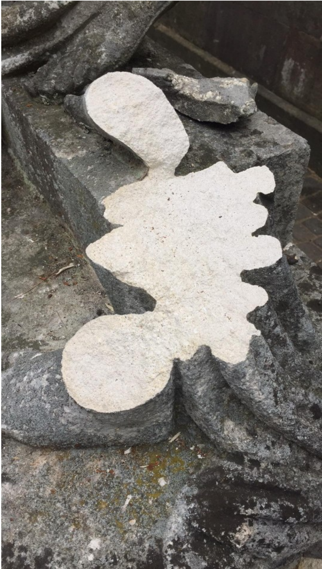
Fot. 3 Obiekt przed pracami interwencyjnymi, stan po uszkodzeniu przez drzewo
