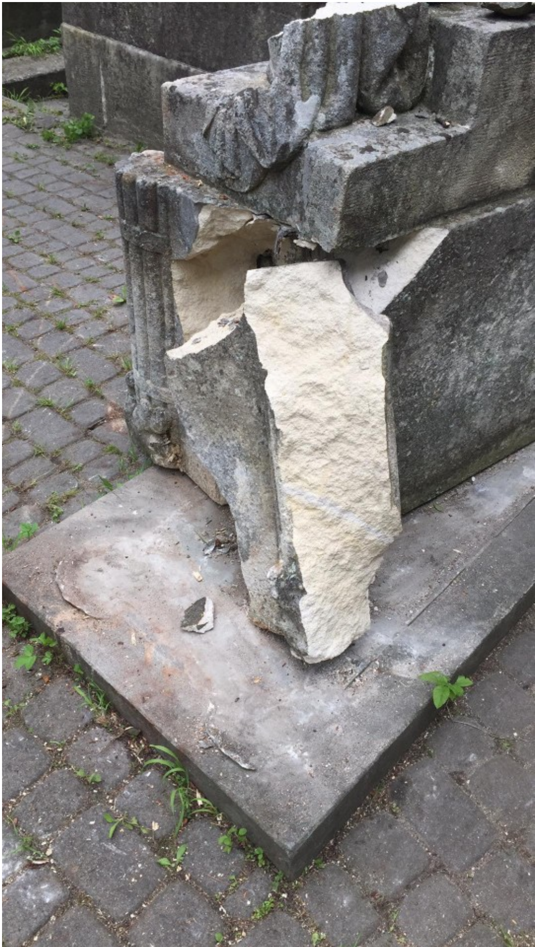
Fot. 4 Obiekt przed pracami interwencyjnymi, stan po uszkodzeniu przez drzewo
