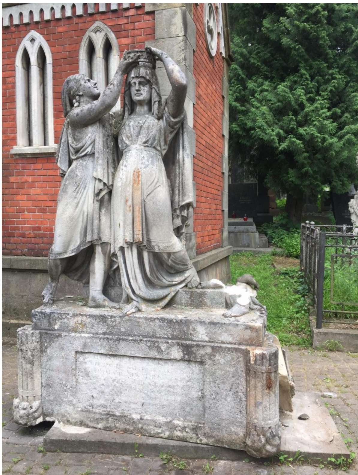
Fot. 1 Obiekt przed pracami interwencyjnymi, stan po uszkodzeniu przez drzewo
