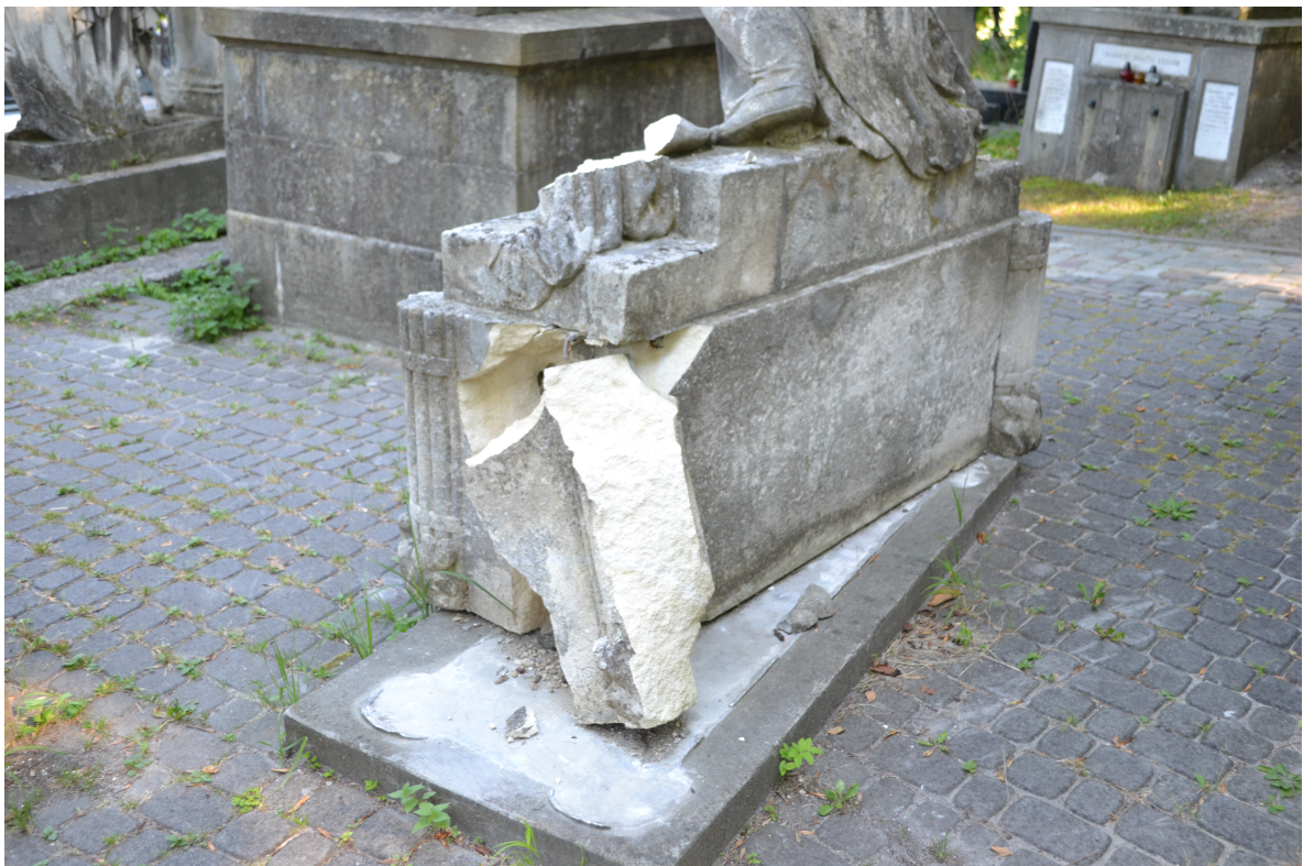
Fot. 8 Obiekt przed pracami interwencyjnymi, stan po uszkodzeniu przez drzewo
