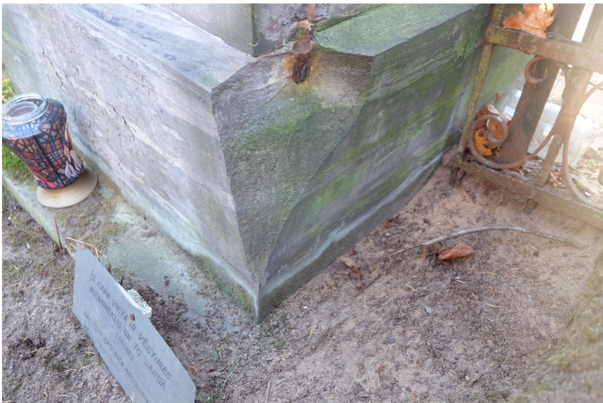
Fot nr 12. Nagrobek Wandy i Konstantego Czerwińskich z cmentarza św. Michała w Rydze, Łotwa. Widoczne wykruszenia spowodowane mocowaniem ogrodzenia. Listopad 2020 r.
