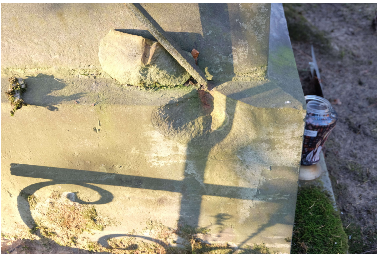
Fot nr 13. Nagrobek Wandy i Konstantego Czerwińskich z cmentarza św. Michała w Rydze, Łotwa. Widoczne wykruszenia spowodowane mocowaniem ogrodzenia. Listopad 2020 r.
