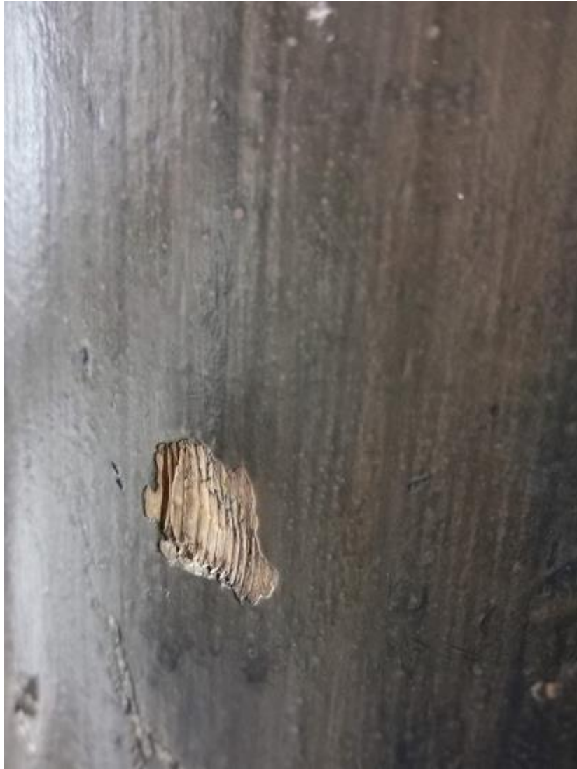
Zniszczenia powierzchni szafy i prospektu.
