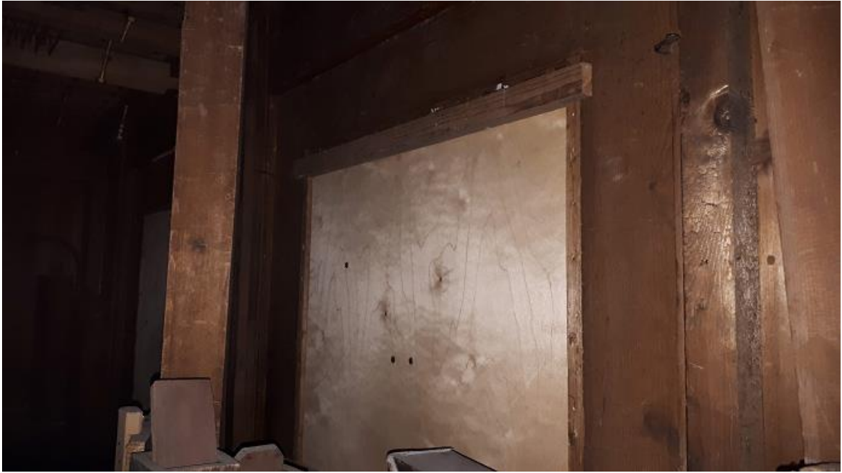
Konstrukcja szafy ,widoczna wtórna płyцина.
