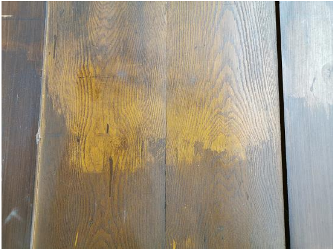
Zniszczenia powierzchni szafy i prospektu.
