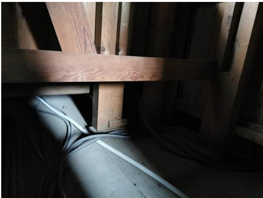
Podłoga techniczna i konstrukcja instrumentu i szafy.
