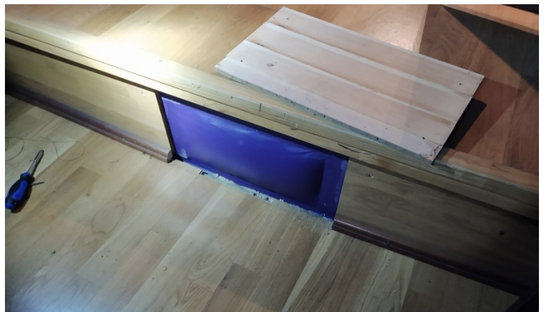
29. Otwór wlotowy do kanału rozdzielającego powietrze z nieistniejącego oryginalnego miecha.
