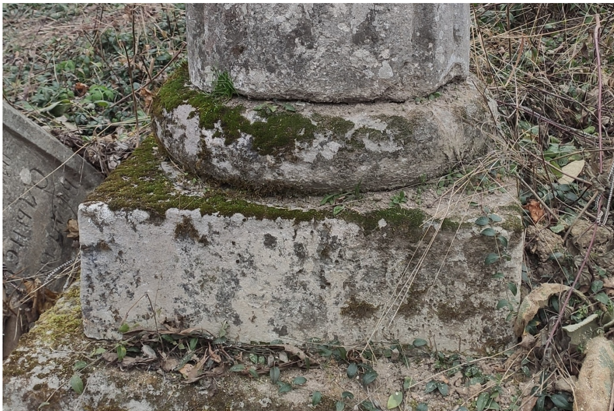
Fot. nr 7. Nagrobek NN z wazą z Cmentarza Bazyliańskiego w Krzemieńcu, Ukraina. Fragment podstawy kolumny, front. Widoczny brak spoiny, mchy, porosty, ubytki formy powierzchniowej. Stan z grudnia 2020 roku.
