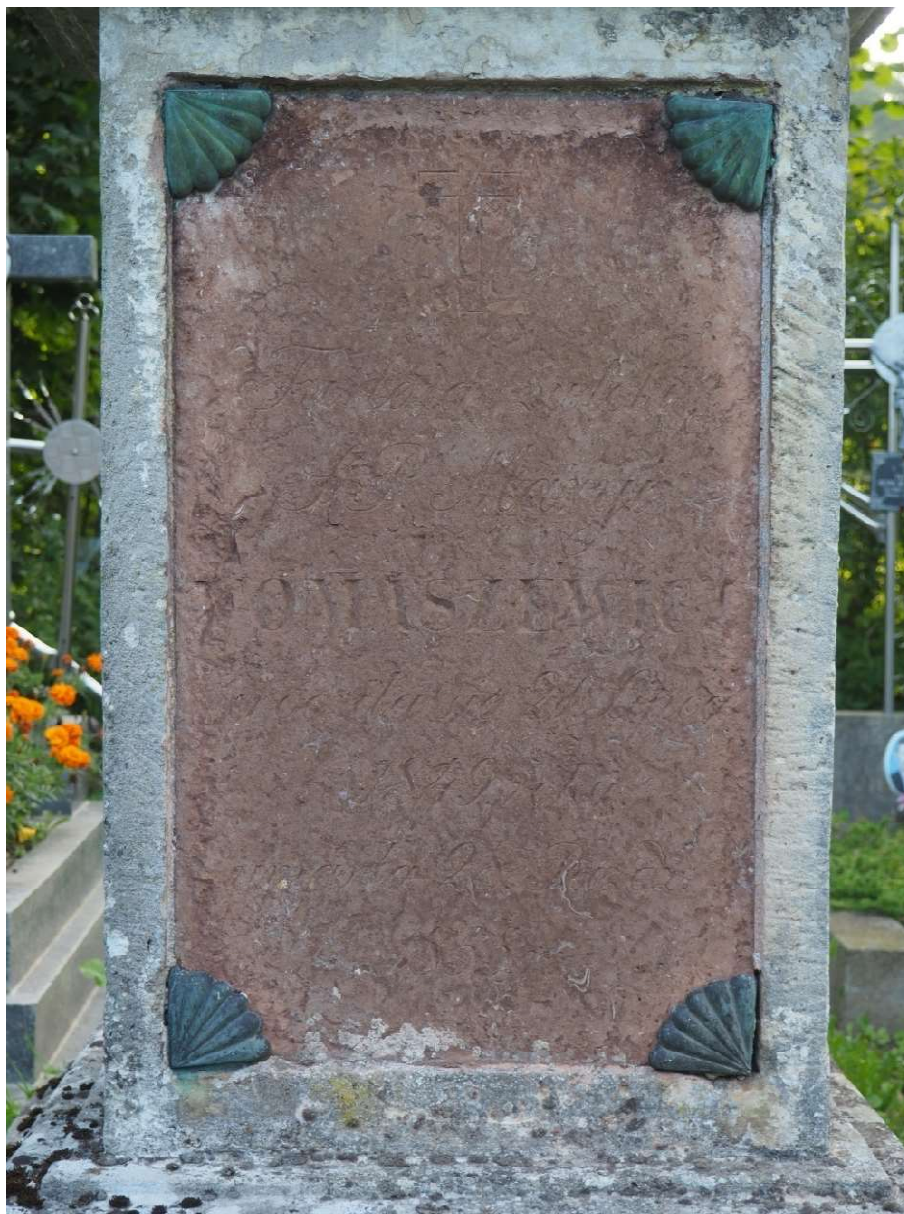
Fot. nr 7. Nagrobek Maryi Tomaszewicz z Cmentarza Bazyliańskiego w Krzemieńcu, Ukraina. Płyta inskrypcyjna z wapienia zbitego, front. Widoczna utrata poleru, ubytki warstwy powierzchniowej, zwiędzelina wapienia zbitego, zielone nawarstwienia chemiczne na elementach metalowych. Stan z października 2020 roku.
