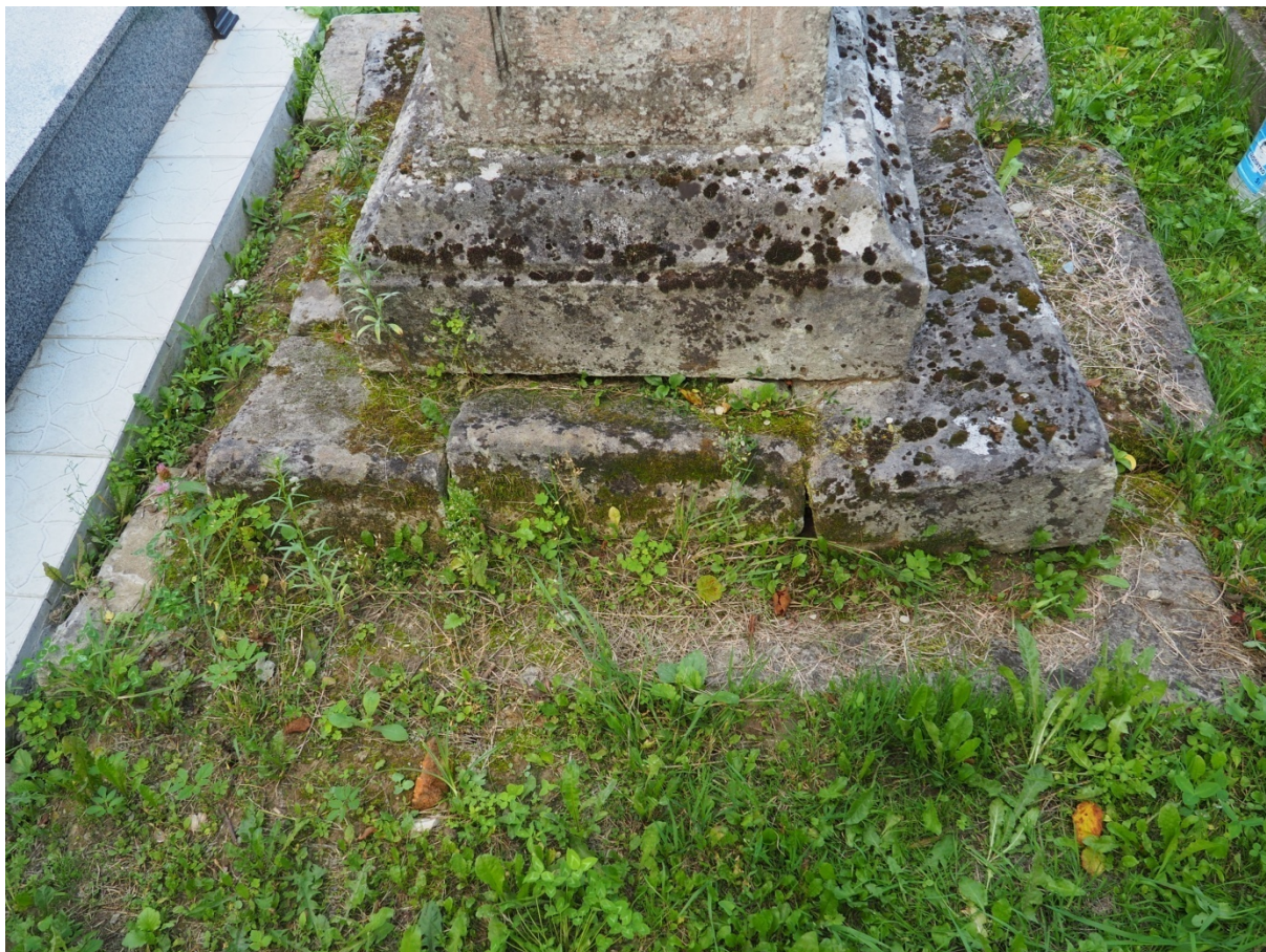
Fot. nr 17. Nagrobek Maryi Tomaszewicz z Cmentarza Bazyliańskiego w Krzemieńcu, Ukraina. Fragment stopni podstawy, tył. Widoczne przesunięcia bloków kamiennych, liczne kolonie mikroorganizmów (szczególnie mchy i porosty). Stan z października 2020 roku.
