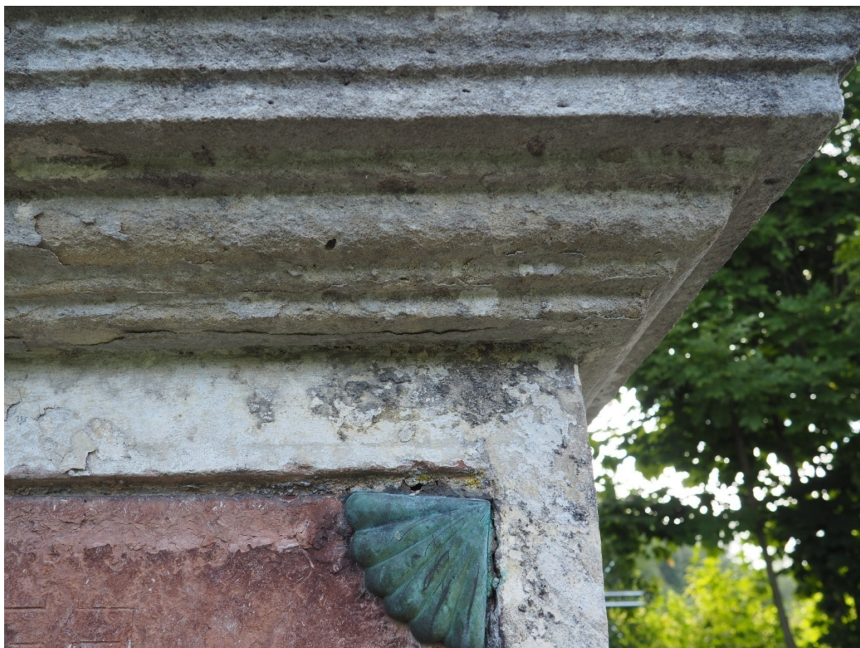
Fot. nr 13. Nagrobek Maryi Tomaszewicz z Cmentarza Bazyliańskiego w Krzemieńcu, Ukraina. Widoczna fragment ze złuszczejącą się warstwą powierzchniową, cokół, front. Stan z grudnia 2020 roku.
