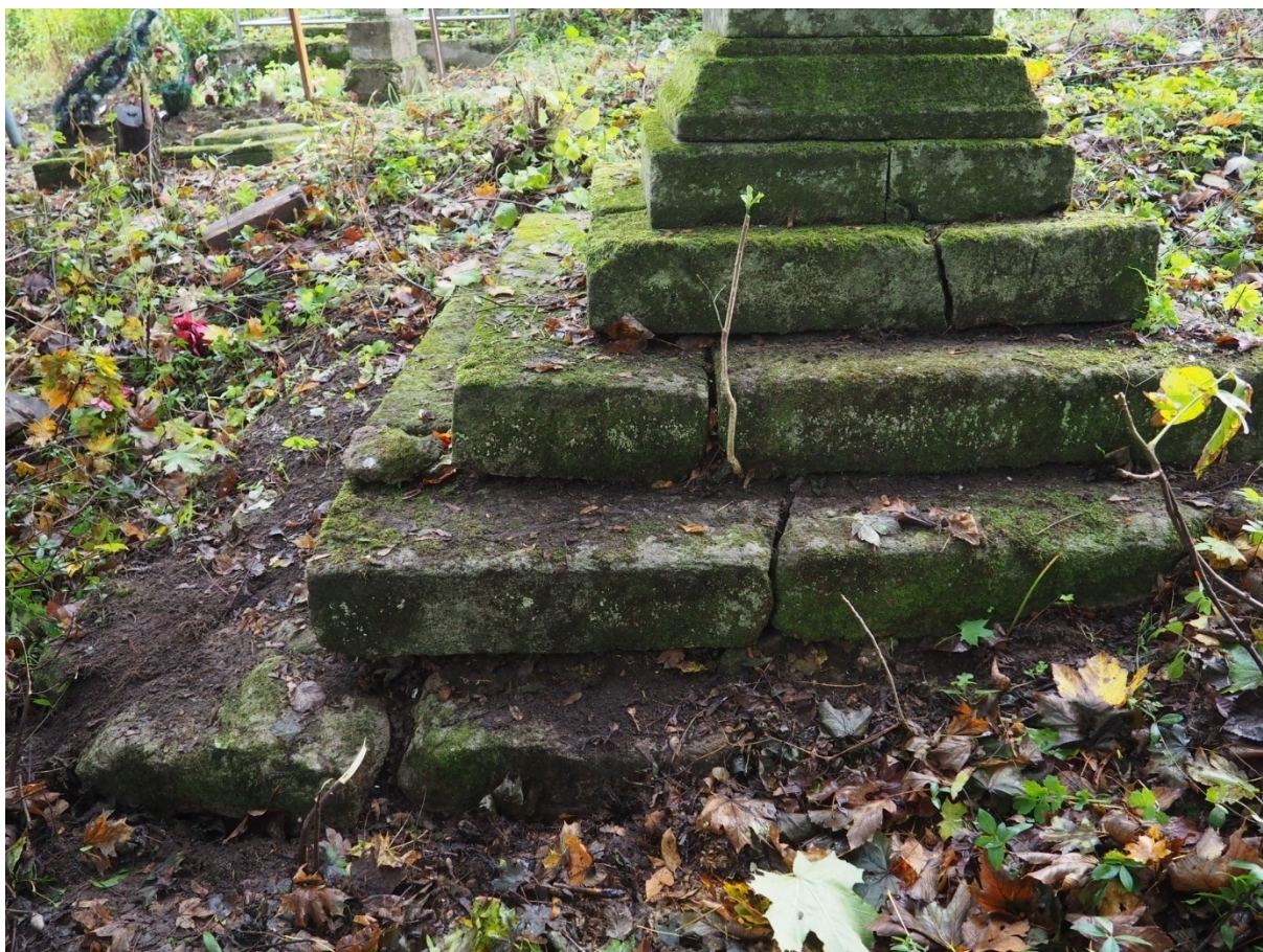
Fot. nr 9. Nagrobek Kamilli Malindowskiej- Cholodeckiej z Cmentarza Bazyliańskiego w Krzemieńcu, Ukraina. Fragment podstawy z prawej strony, widoczne nawarstwienia biologiczne (liczne skupiska mchów) oraz pęknięcia materiału skalnego. Stan z października 2020 roku.
